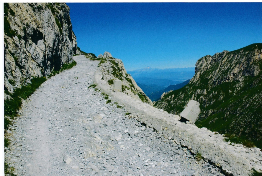
Auf dem Abschnitt vom Col de la Boaire hinauf zur berühmten Kehre hat die Straße durch Auswaschungen bereits viel an Substanz verloren. Blick auf den Monte Viso → Runde 21.
